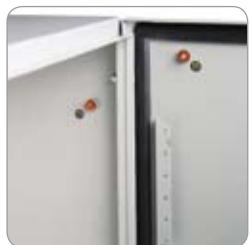
Приваренные болты заземления
